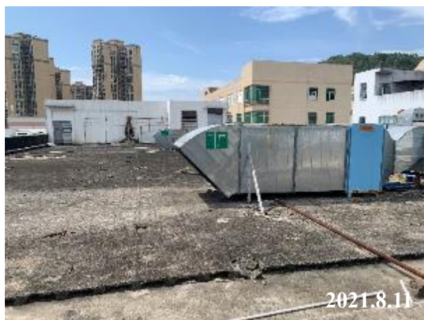
项目废气治理设施
