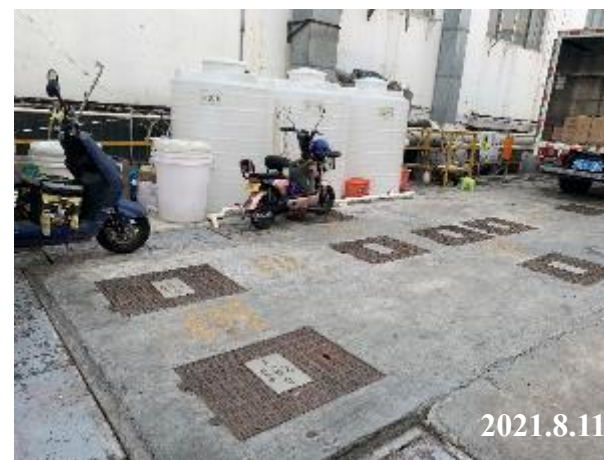
项目废水治理设施
